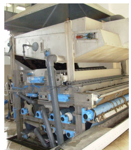
Ταινιοφιλτράτρεσσα για την αφυδάτωση της ιλύος στη ΜΕΛ Μυτιλήνης
