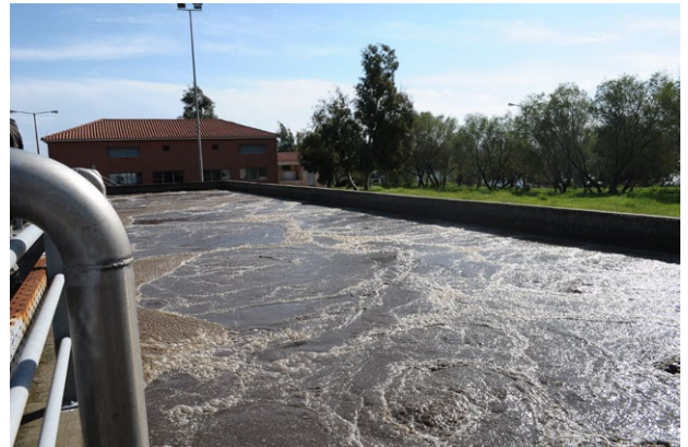
Βιοαντιδραστήρας ενεργού ιλύος για την επεξεργασία των λυμάτων στη ΜΕΛ Μυτιλήνης
